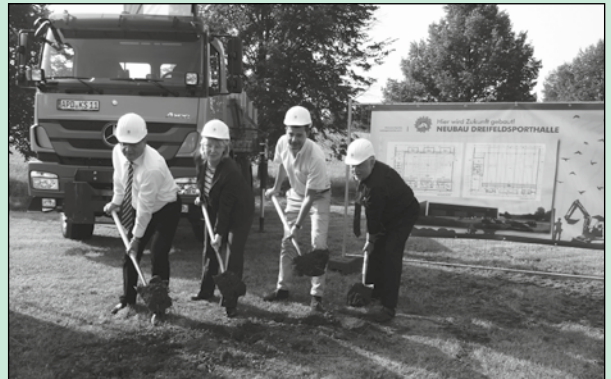
Der offizielle Spatenstich für den Neubau der Dreifeldsporthalle an der Adolf-Aber-Straße erfolgte.
